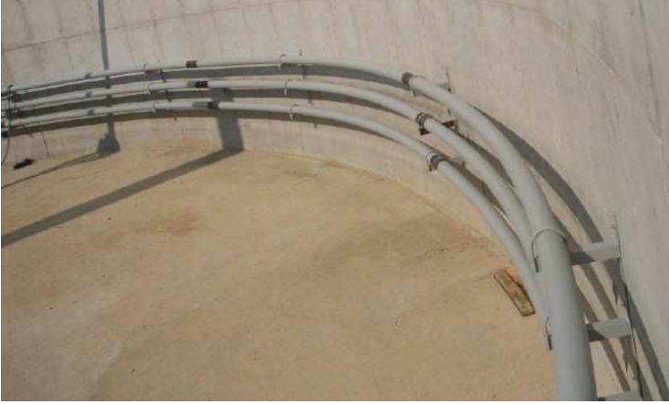
Şekil 26 Çözücü İçerisindeki Isıtma Boruları
