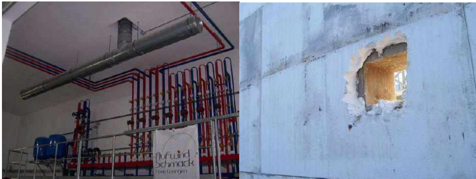
Şekil 25 Biyogaz Tesisi Isıtma Sistemi (solda), Beton Sindirici, Çözücü Bölümünün Yalıtımı (sağda)
