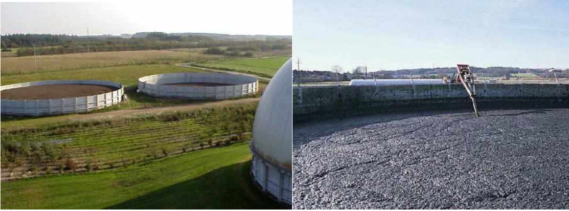
Şekil 34 Membran kaplı depolama tankları
