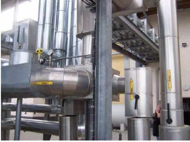
Şekil 23 Yalıtılmış Gaz Boruları
