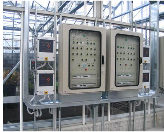
Resim 5: İklim Kontrol Sistemi
