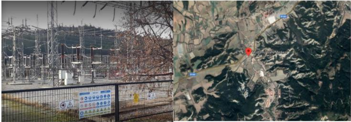
Şekil 3. Mudurnu Trafo Merkezi
