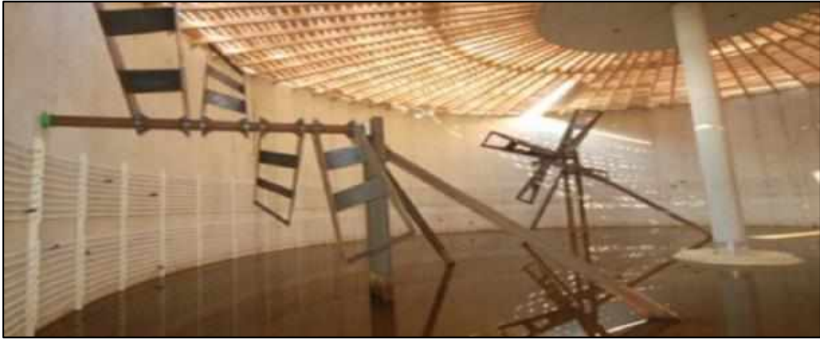
Şekil 12. Biyogaz Tesis İç Kısım
