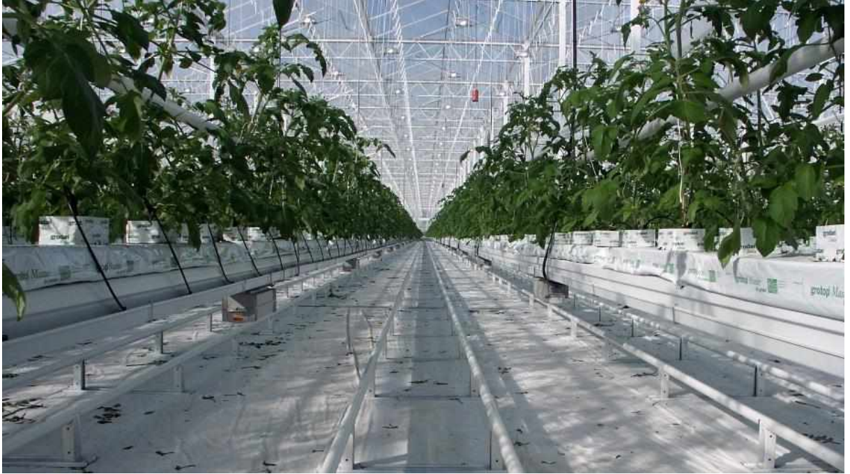
Isıtma sistemi ve askılı yerleştirme olukları
